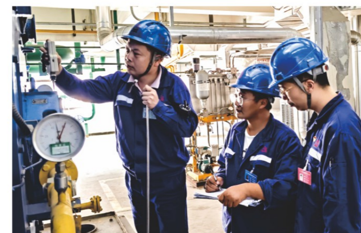
嘉通项目员工正在进行运行巡检
